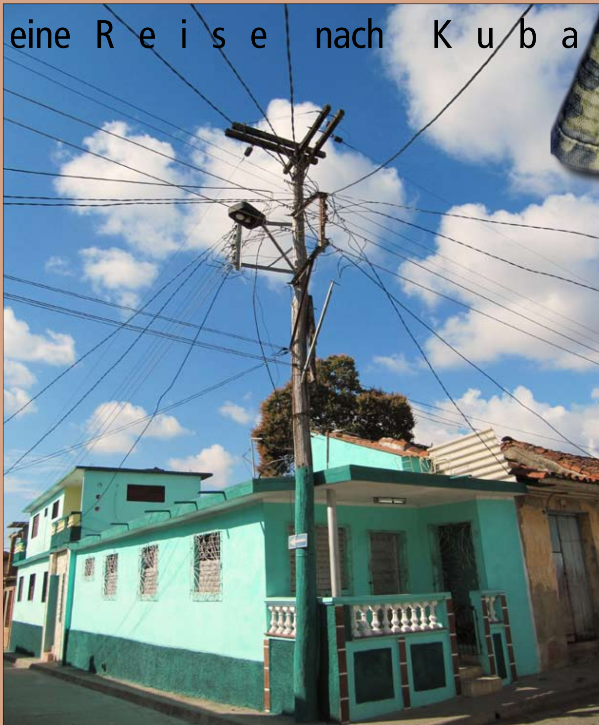
Abbildung: Elektroinstallation a la Kuba; Foto: Joachim Schulze
